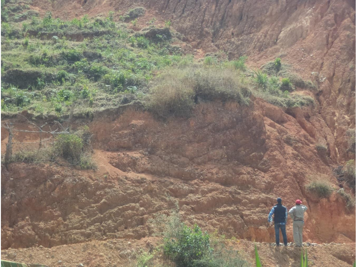
Figura 7.Deslizamiento 3, visualización de la masa desplazada. Elaborado: Equipo consultor.
