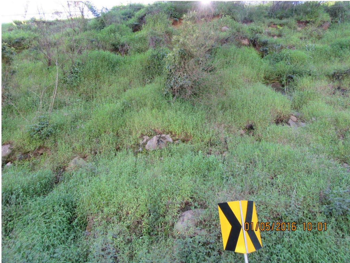
Figura8. Coluviales en la vía Veracruz-Olmedo, la señalética de tránsito presenta un ligero desplazamiento, lo que representa la actualidad del movimiento. (UTM X =657610 Y= 9560752) Elaborado: Equipo consultor.
