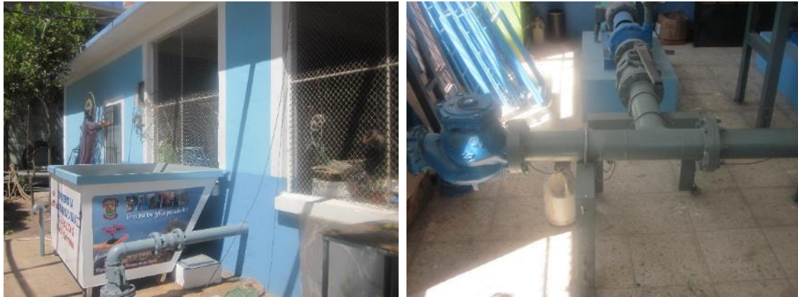
Fotos de Conexión de la succión, caudalímetro y bomba n°1
