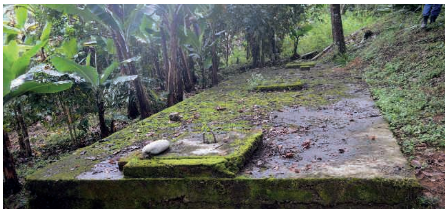
Planta tratamientos aguas servidas Lauro Guerrero.
