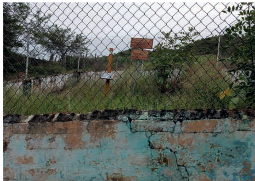
Fotografía 5. Estado de la infraestructura de los Petroglifos de La Rinconada
