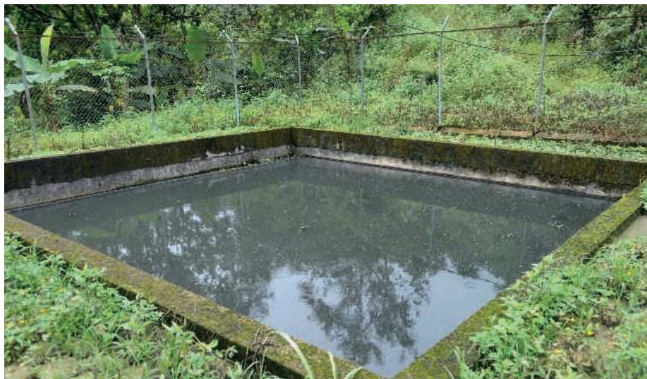
Planta tratamientos aguas servidas de Orianga.
