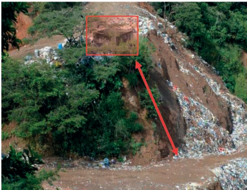
Celda Bio-peligrosos y riesgo desbordamiento del talud.
