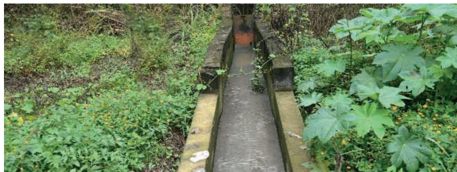
Planta tratamientos aguas servidas Orianga.
