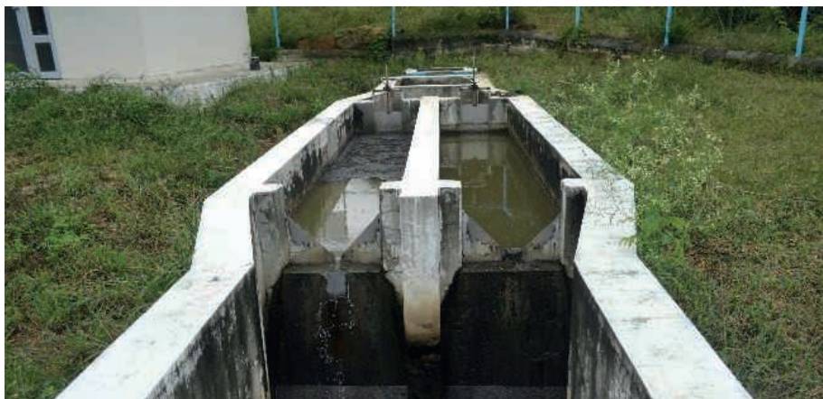
Planta tratamientos aguas servidas Yamana.
