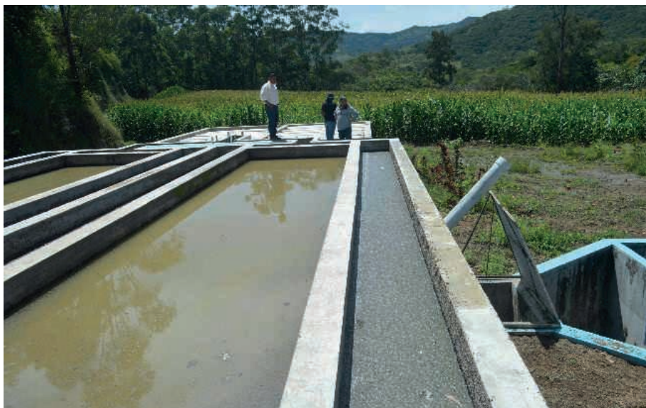
Planta tratamientos aguas servidas Catacocha.
